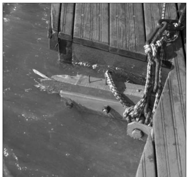
Jäät leikkasivat kulkusillan 50x175 tukipalkit poikki jään alapinnan tasolta.
